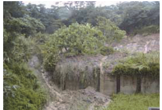
土砂の崩壊状況(6/14)
